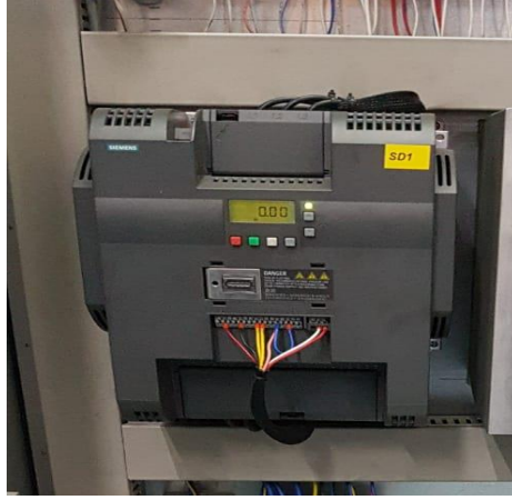
Şekil 4.2. Hız kontrol ünitesi
